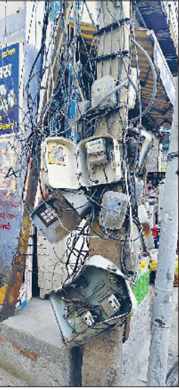
भिवानी। सड़क मार्ग के बीच टूटा एवं धंसा सीवरज का मैनहॉल व ढक्कन तथा रोहतक गेट पर स्कूल की दीवार के साथ जमा गदा पानी व बिजली के पोल पर अव्यस्थित एवं टूटे पिल्लर बॉक्स में लटकते मीटर।
