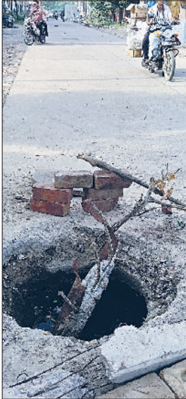
भिवानी। सड़क मार्ग के बीच टूटा एवं धंसा सीवरज का मैनहॉल व ढक्कन तथा रोहतक गेट पर स्कूल की दीवार के साथ जमा गदा पानी व बिजली के पोल पर अव्यस्थित एवं टूटे पिल्लर बॉक्स में लटकते मीटर।
